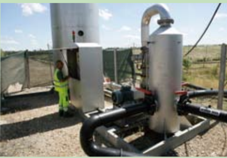
Le biogaz issu de la fermentation des déchets stockés est canalisé par un réseau sur l'ensemble du site puis brûlé par 2 torchères à 1 000 °C environ, fonctionnant 24/24 h et consommant 1 500 m 3 de biogaz par heure. Organom lance une étude sur la valorisation de ce biogaz, composé essentiellement de méthane, en énergie électrique.
